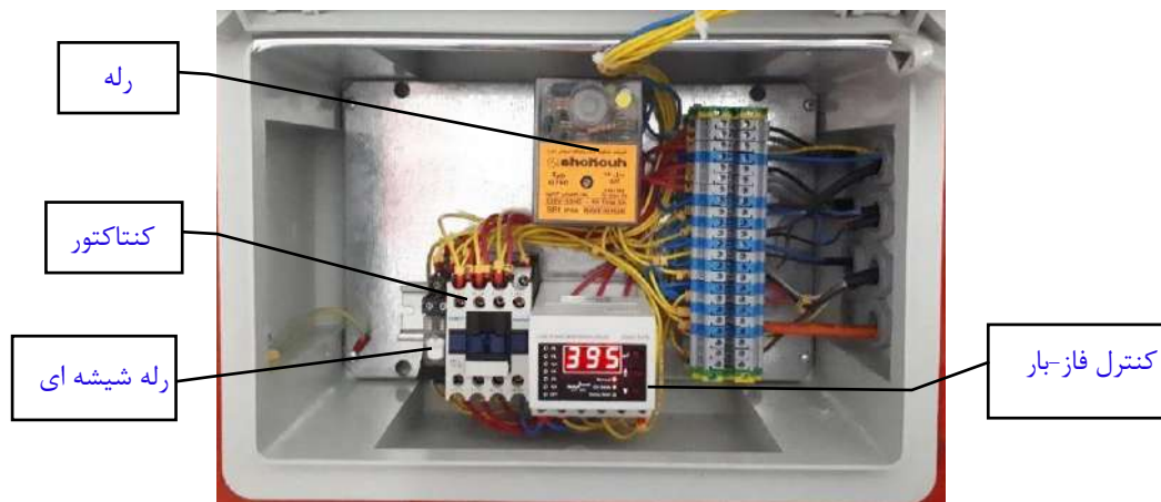
شکل ۱۲) شکل داخل تابلو برق هیتر
