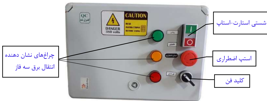
شکل ۱۱) درب تابلو برق هیتر
